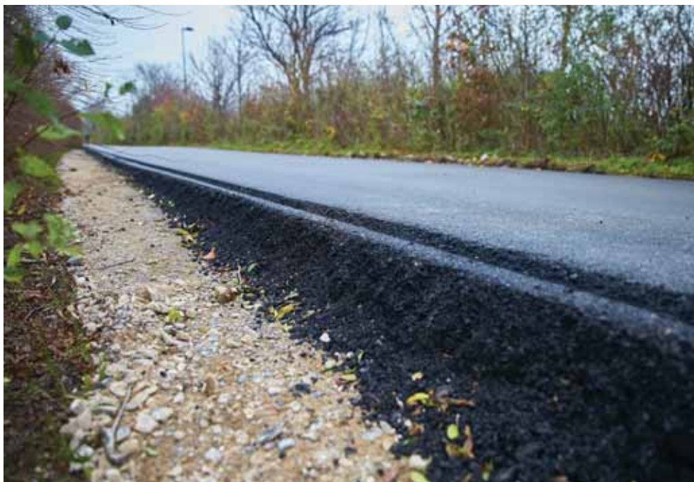
Den nye supercykelsti langs Hold-an Vej er bestemt ikke, blevet som forventet. Og problemerne fortsætter. Foto: Flemming Schiller.
